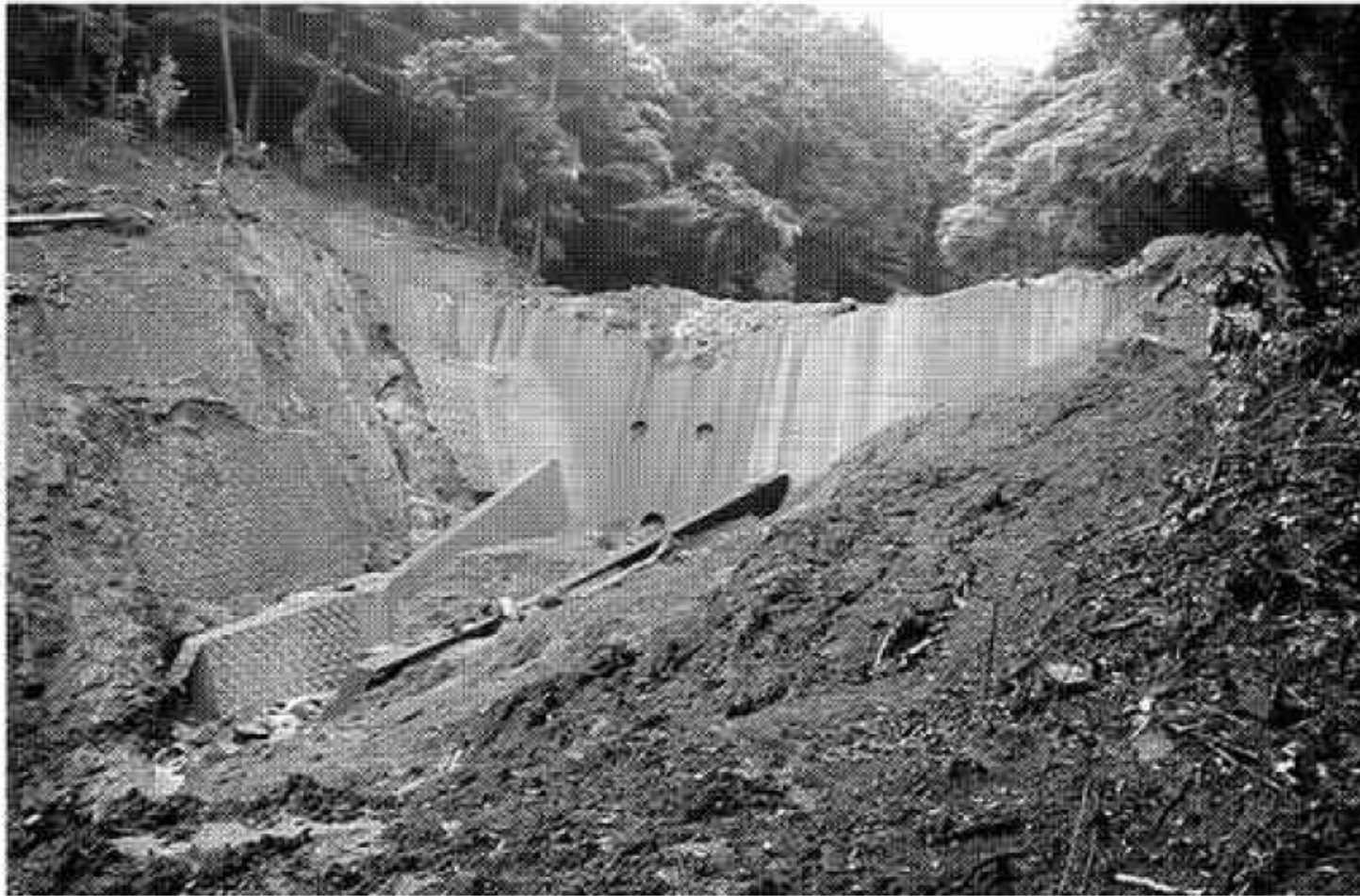
土石流発生後の逢初川の砂防ダム
