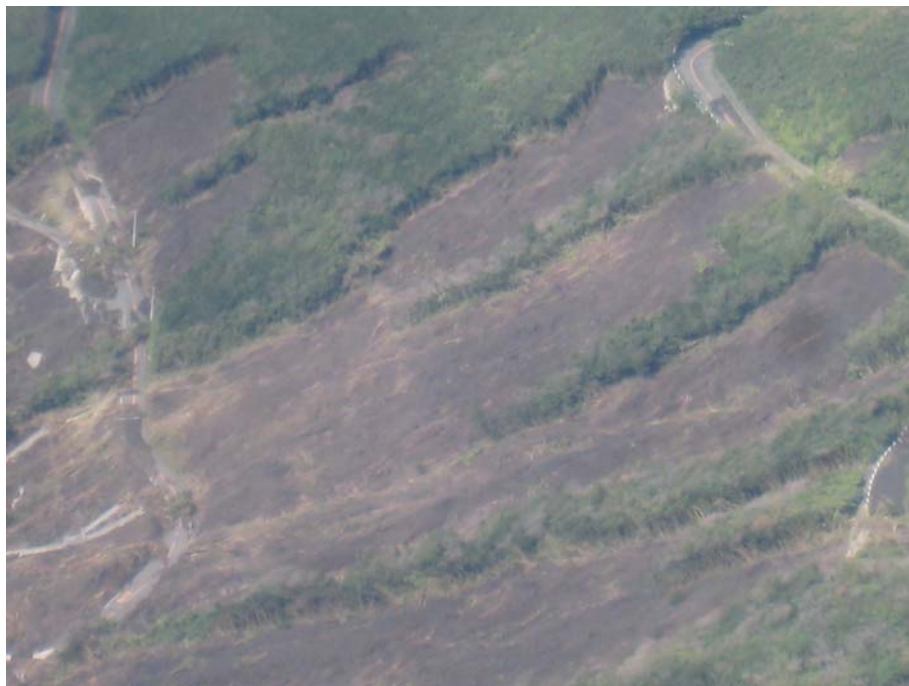
写真-4 大規模表層滑り発生の上端。厚さ2m程度の複数の表層滑りが複合したと思われる。
