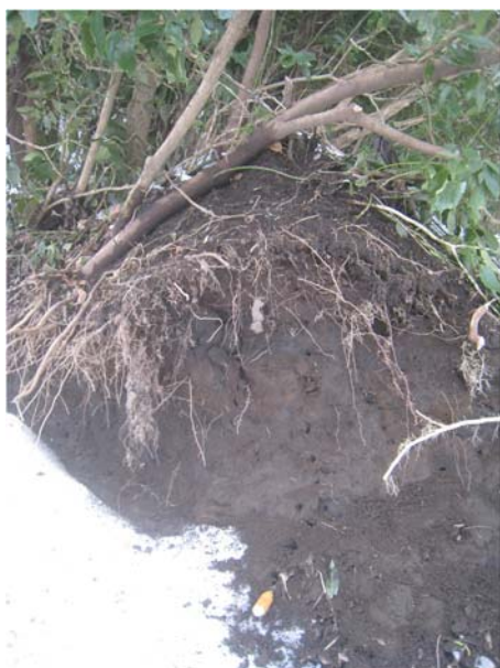
図-8 斜面上部地山際の滑り境界地層断面。 明確な層序は見えない。
