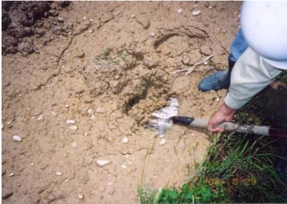
写真 - 3 左岸側地山の状況（足で振動を加えると容易に液状化）
