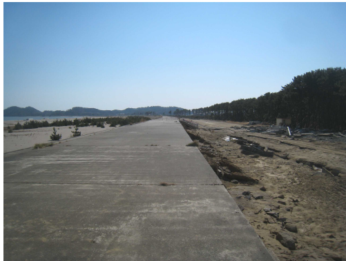
野蒜海岸堤防と津波による背後の激しい洗掘
