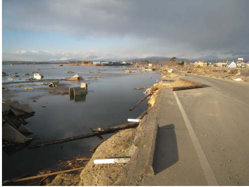
道路盛土沿いの津波洗掘
