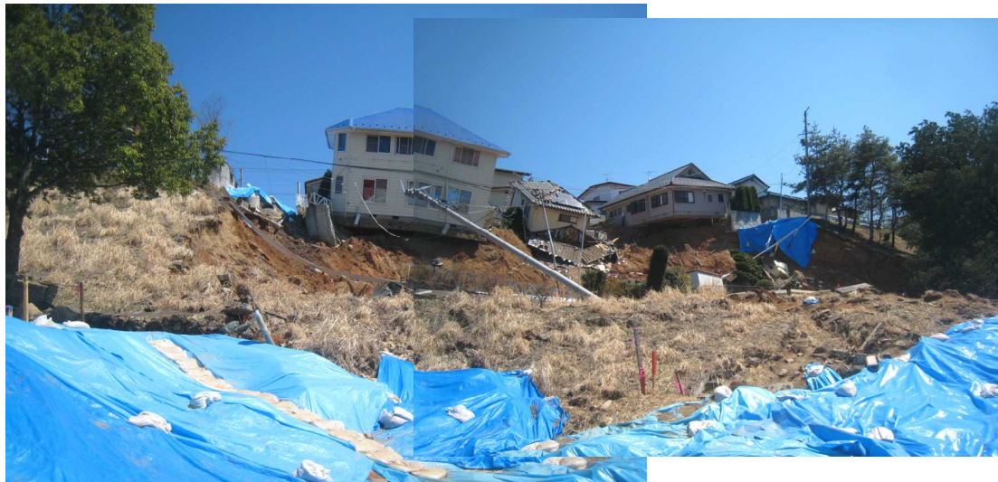
西側斜面崩壊の正面からの見え方、枯草の斜面が剛体的に前に滑り落ちたようである。
