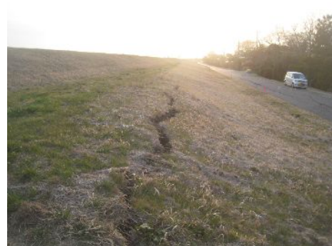
写真-18 堤防の亀裂
