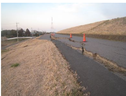
写真-23 利根川左岸堤防の亀裂と沈下
