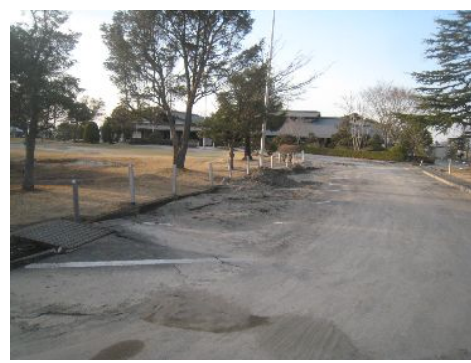
写真-20 クラブハウス付近の噴砂
