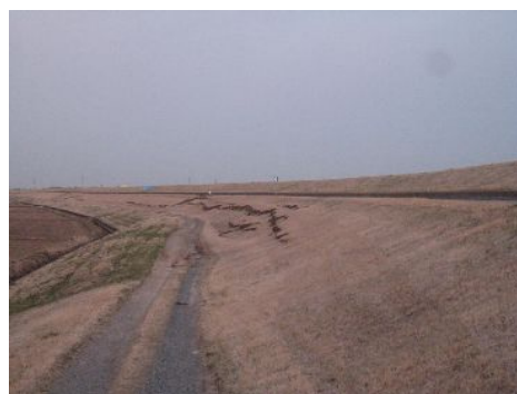
写真-24 利根川左岸堤防の亀裂と沈下
