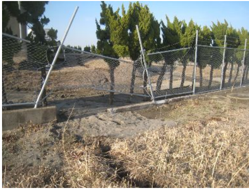
写真-15 河内町水道事務所敷地東側フェンス境界
