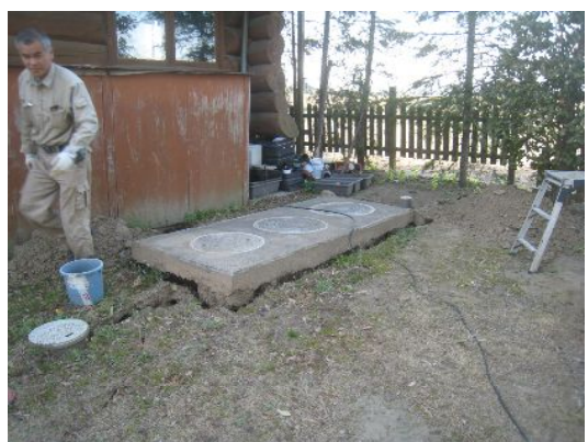
写真-8 汚水処理槽の浮上り。
