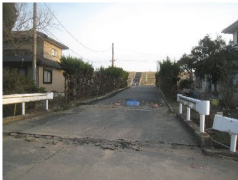
写真-19 橋の付近での圧縮ひずみ
