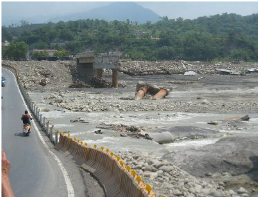
図-5 橋梁の洪水（土石流？）倒壊。泥岩基礎に打設した鋼管杭が折れ曲がっている。
