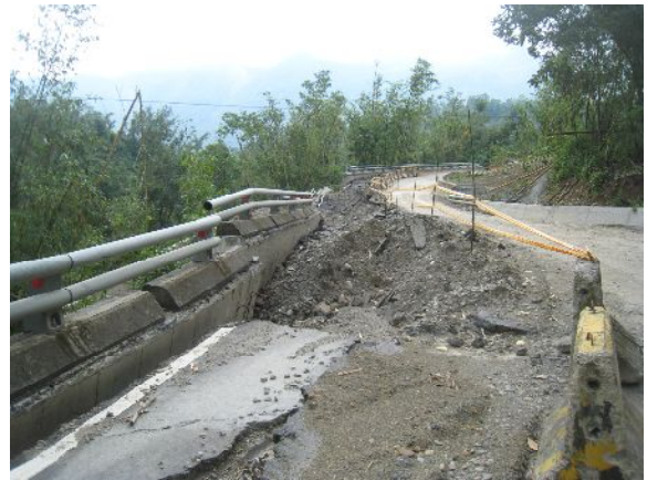
図-18 帰り道に見えた道路擁壁の被害。雨量が非常に多いと、崩壊モードが地震に近づく印象を受けた。
