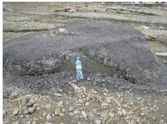
図-15 風化の進んだ泥岩塊。玉ねぎ状に風化が進んでいる。
