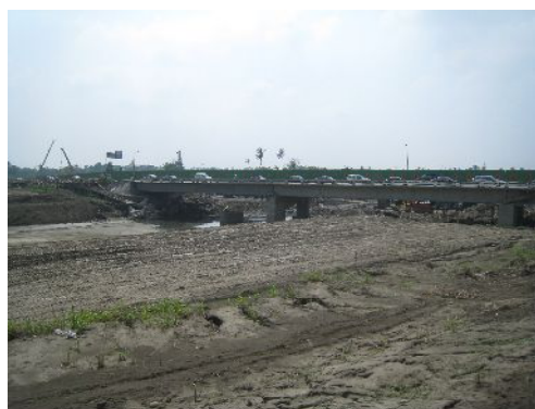
図-3 橋梁の桁に近い高さまで堆積した細粒の多い堆積土。桁には流木が残り、水が橋により堰上げられ洪水に繋がったようだ。
