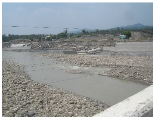
図-4 河川湾曲部で削られた河川堤防
