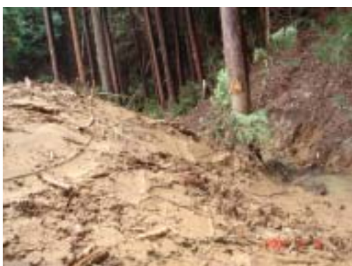
図-8 崩壊部先端付近の杉の幹に枝が付着し 泥跳ねが付いている
