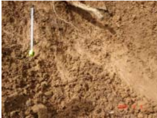
図-14 地点 2)の崩壊エリアの左右の地山からは水が滲みだしているところが見られた
