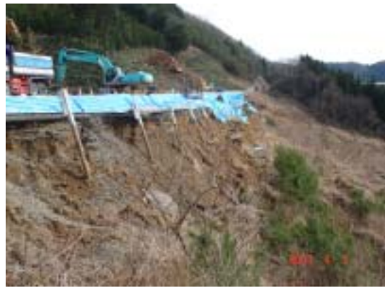
図-17 地点 4)では腹付け盛土斜面の剛体的移動によって1車線が1以上の沈下を起こしていた
