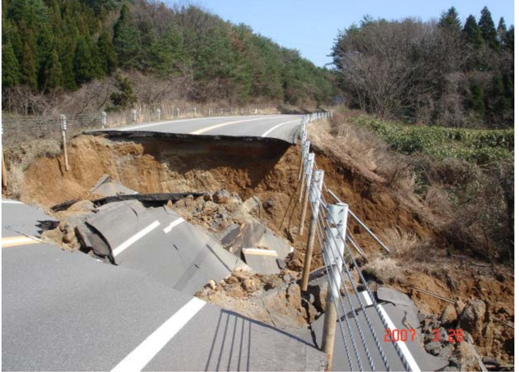
能登道路中島町谷内付近盛土崩壊(深い滑り陥没)
