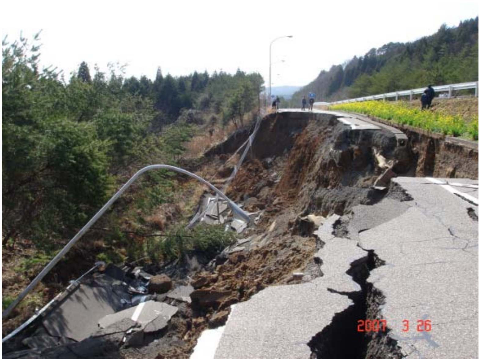
能登道路横田料金所付近盛土崩壊
