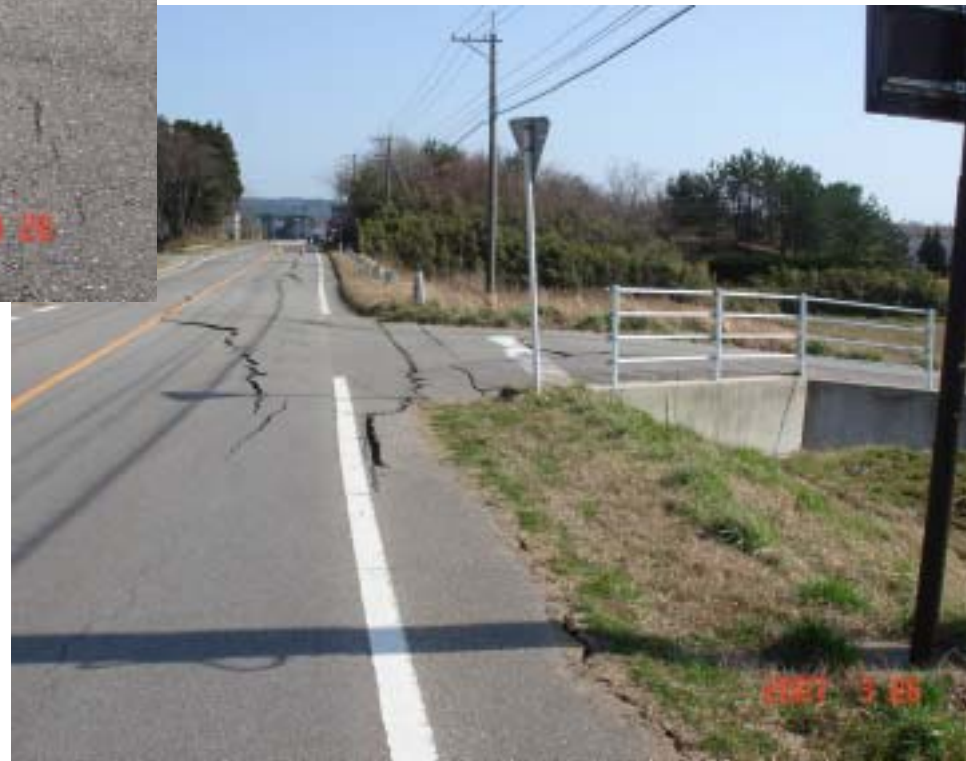
富来中浜道路盛土亀裂沈下
