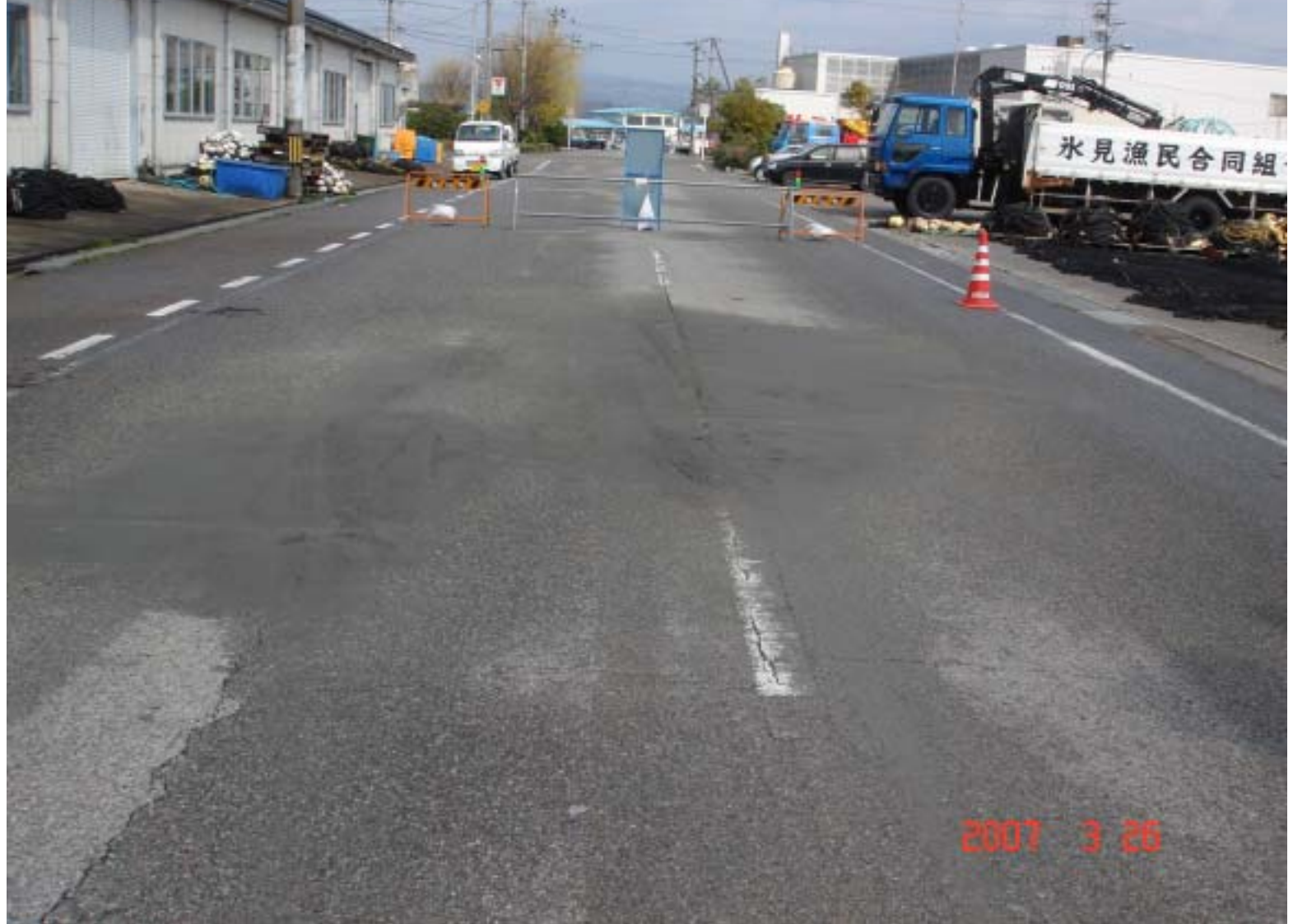
富山県氷見市氷見漁港岸壁 (背後地盤小規模液状化・目開き・沈下)
