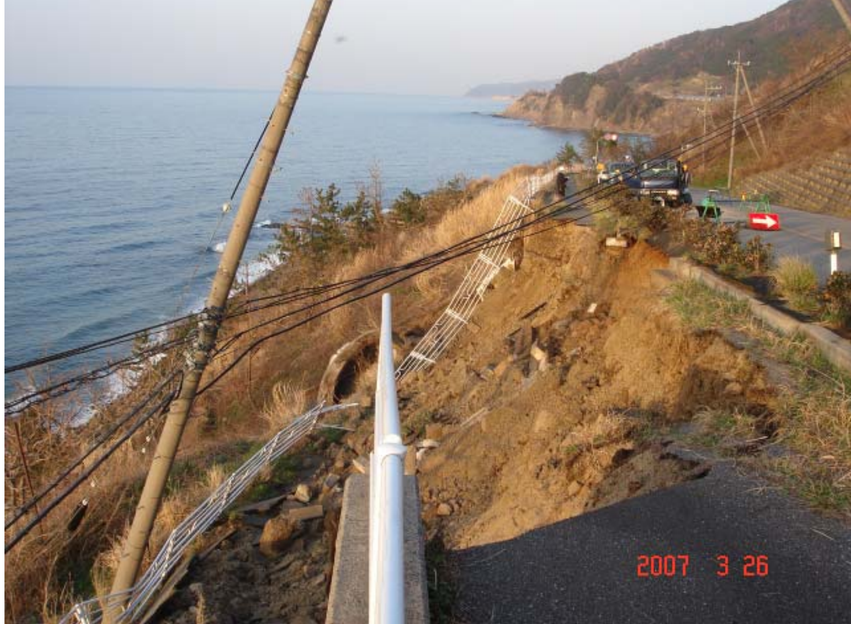
輪島市大野町宍崎付近(すし付け成土の崩壊)
