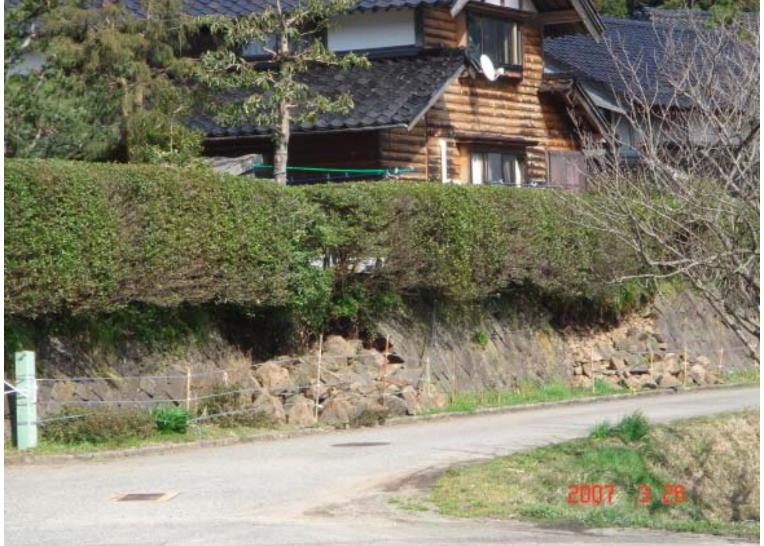
富来付近空積み石垣崩壊
