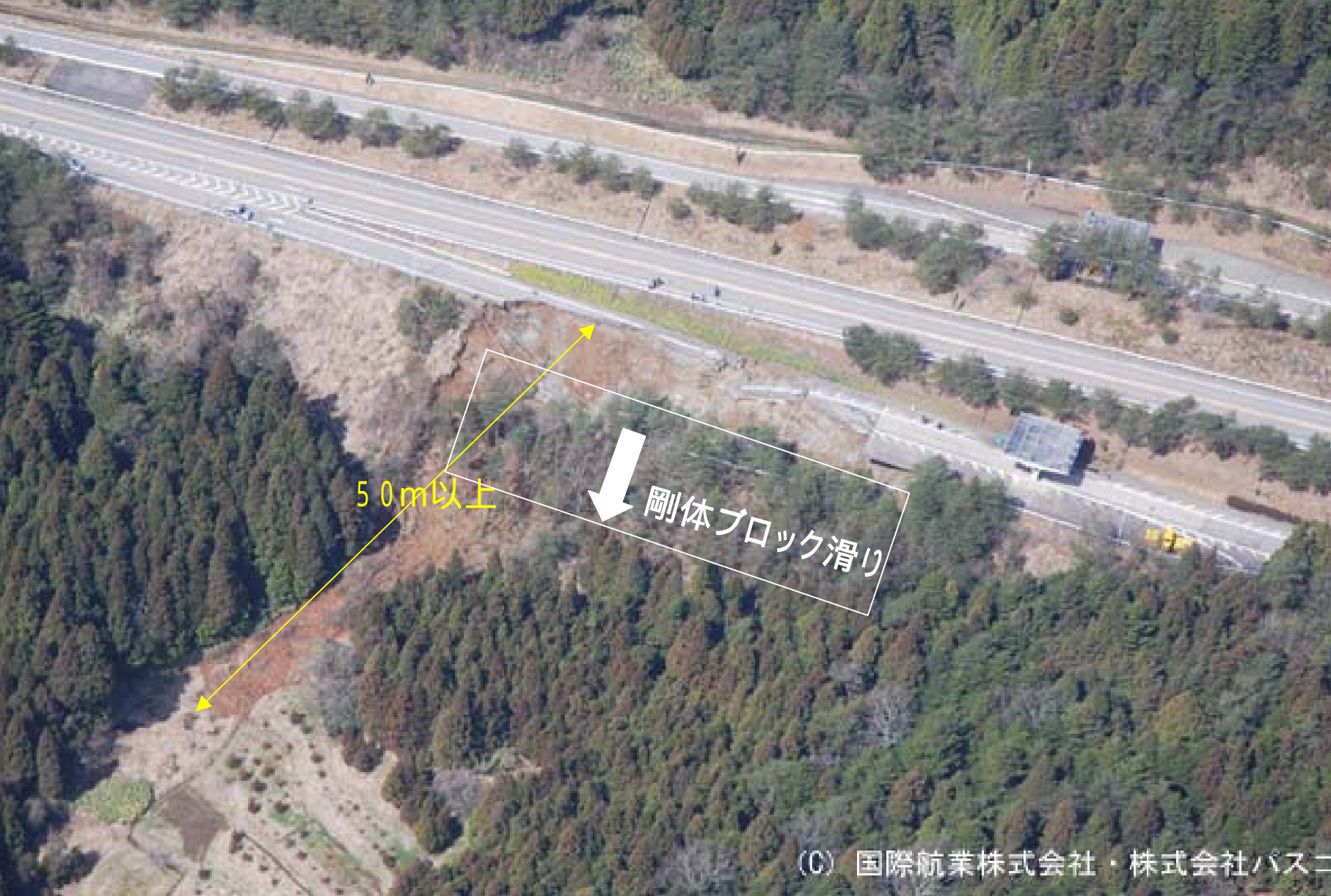
能登道路横田料金所付近盛土崩壊(国際航業HPより)
