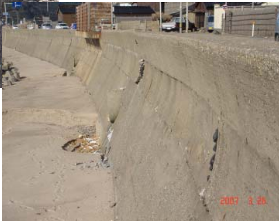
輪島市国道249海岸道路盛土の沈下
