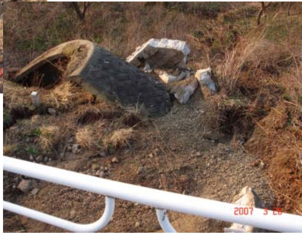
輪島市大野町寅崎付近(土留め壁倒壊)
