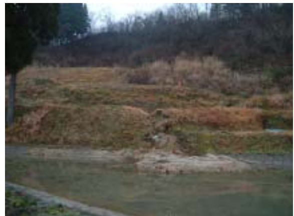
写真-16 パイピングによる池の破堤
