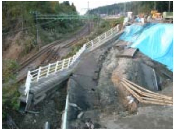
写真-4 川口町天納での国道 17 号線と JR 上越線の併設盛土崩壊とライフライン被害
