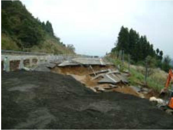
写真-1 高速道路盛土の路肩滑り (堀之内町竜光)
