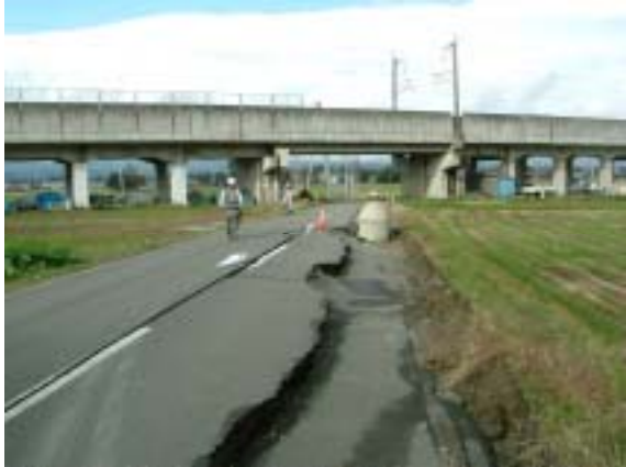
写真-9 長岡市渡沢町新幹線高架橋沿いの下水埋設部分の沈下とマンホールの浮き上がり
