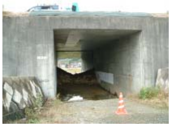
写真-2 小千谷インター付近での盛土の変形・移動によるカルバートの沈下と継ぎ目の開口
