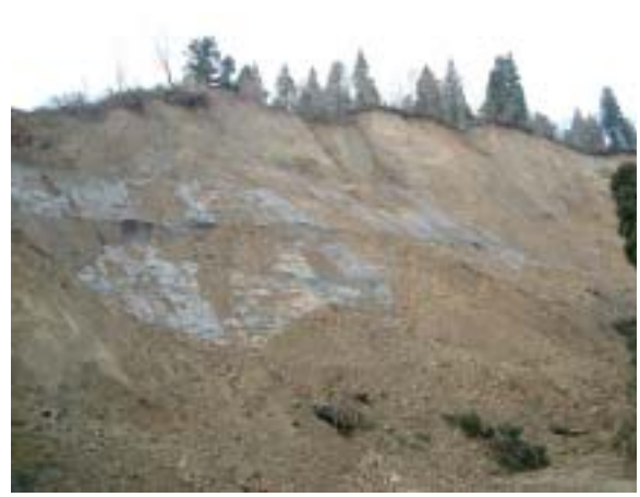
写真-18 高さ70m、傾斜36°ほどの滑り面はほぼ水平な層理面が表れ、湧水が見られる
