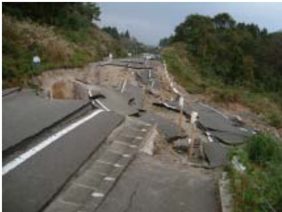
写真-3 小千谷市塩殿での国道 117 号線盛土崩壊。路肩のライフラインも巻き込んだ交通途絶
