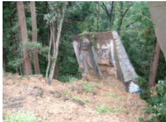
写真-6 造成地周縁部の重力式擁壁 施工継目 2 スパン間で崩壊し大きく流れている
