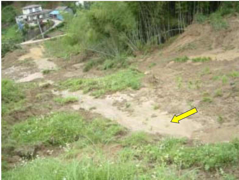
写真 - 3 地滑り斜面状況（多量の湧水を確認）
