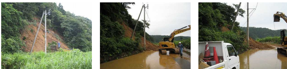
写真 5 刈羽村勝山城址付近の斜面崩壊
