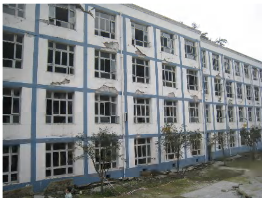
旧校舎のレンガ壁の被害 遠方のさい建物は傾いている。
