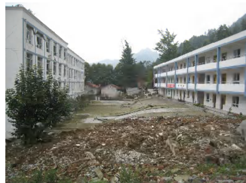
断層の通過した手前の建物は倒壊し、
