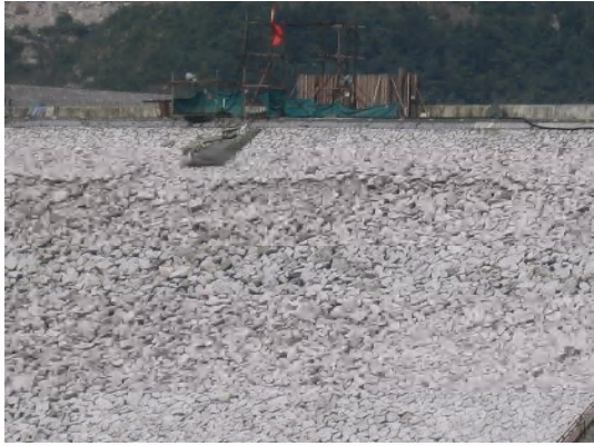
下流法面リップラップ (天端フェンス落下)
