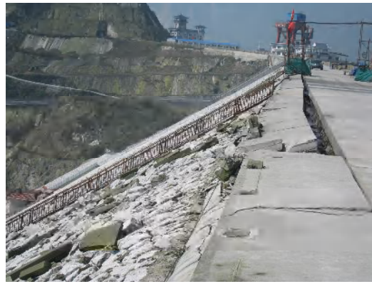
下流法面リップラップの乱れ
