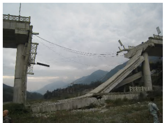
中央のピアから桁が押し出され落下
