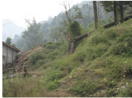
断層上にある右岸のパイプラインの抜け落ち
