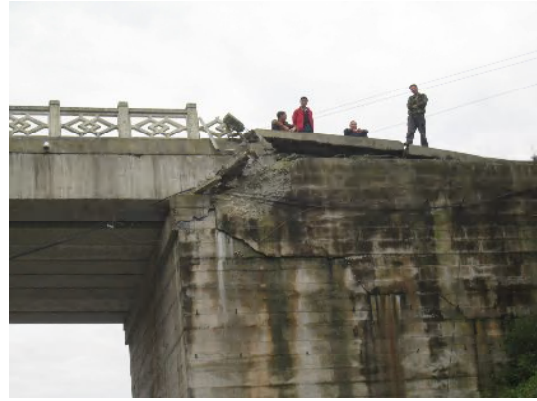
右岸アバット部の圧縮変形
