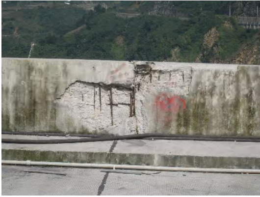
天端止水擁壁ジョイントの圧縮破壊
