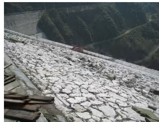
下流法面リップラップの乱れ
