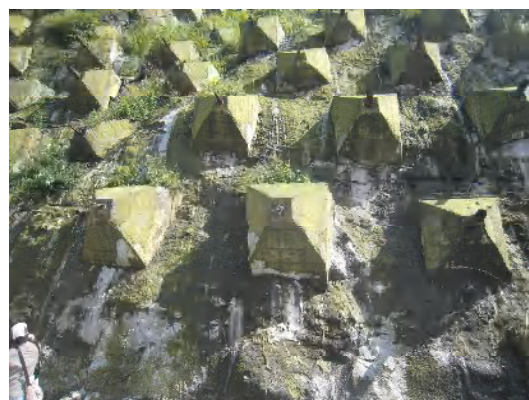
ロックアンカー先端部の破壊
