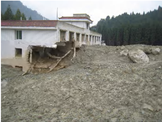
建物の端部はちぎられたが、全体としては持ち堪えた
