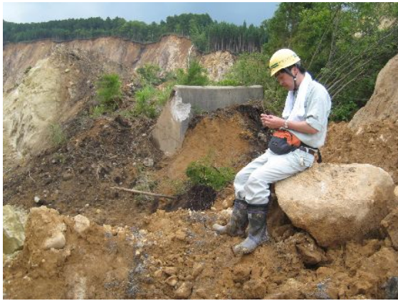
図-12 橋台が南側に傾斜している（E地点付近）。
