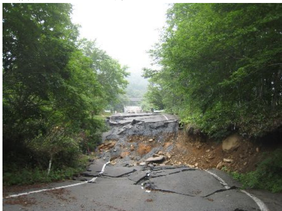
図-22 右岸側の地滑りによる陥没帯
