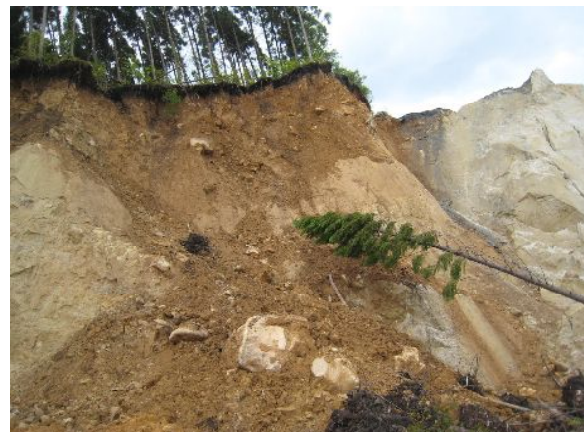
図-11 トップリング的に傾斜した崩壊面と木立の傾斜（E 地点付近から北側の面を見る）
