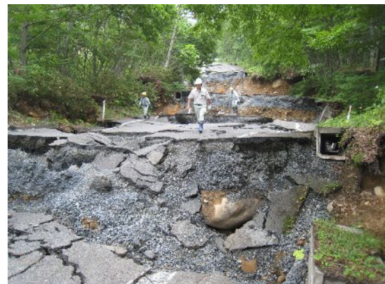
図-23 右岸側の地滑りによる多数の横断亀裂
