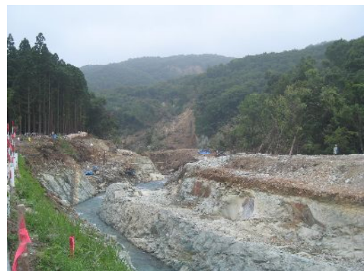
図-17 市野々原河道閉塞（右岸から押し寄せた土塊を避けて、左岸側の岩盤に新たに河道を掘削）
