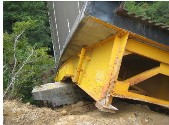
図-21 座屈した鋼桁と破損した左岸側のRCピア
