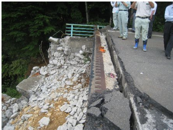
図-20 左岸側の背後地盤に押し込まれた橋台と橋桁ジョイント部
