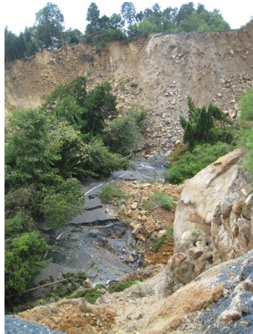
図-9 C 地点の道路が陥没した箇所で崖の上から南側をみる。
