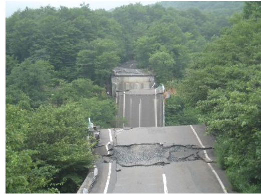
図-19 左岸側からみた崩壊橋梁（路面の圧縮リッジが見える）
