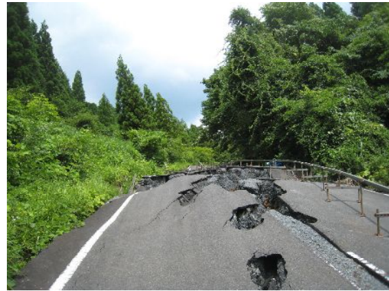
図-7 B地点の崩壊道路から北を見る
