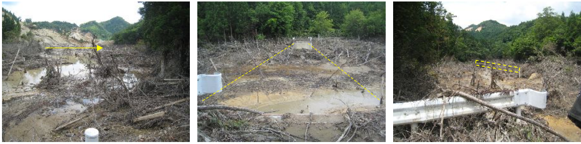
図-5 入江の入口は崩壊土塊が対岸までぶつかり水路を塞ぎ、津波を引起した(a)。架橋位置は橋台だけが残り、沢は泥に埋まり、道路も泥に覆われている(b)。橋桁は 50m ほど上流に押し流された(c)。
