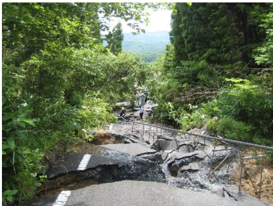
図-6 B地点の崩壊道路から南を見る
