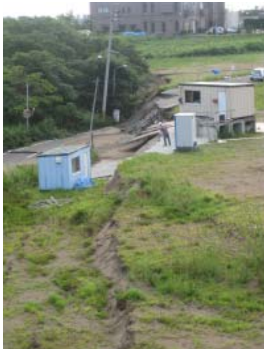
写真-10：クリーンセンター横、山本砂採取場の亀裂（右側が隆起しており、センスも北西落ち断層に整合）
