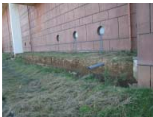
写真-4：最も海岸よりの地下室つき建物海側面（大きな沈下を既に埋め戻ししていた）
