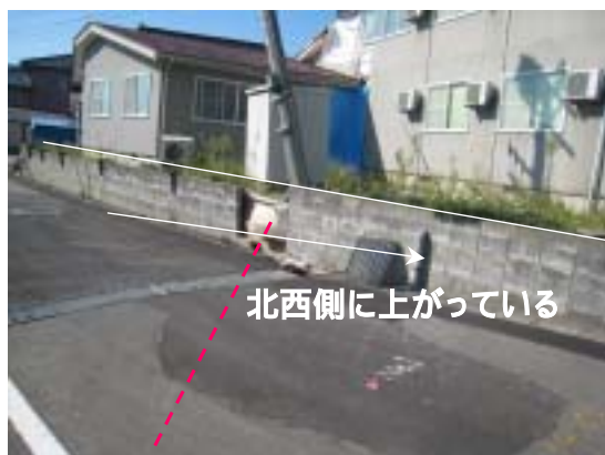
写真-7：松波2丁目の段差(記念公園の亀裂と同一線上にある)
