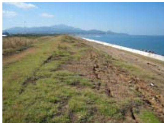
写真-15 柏崎海岸堤防斜面の亀裂
