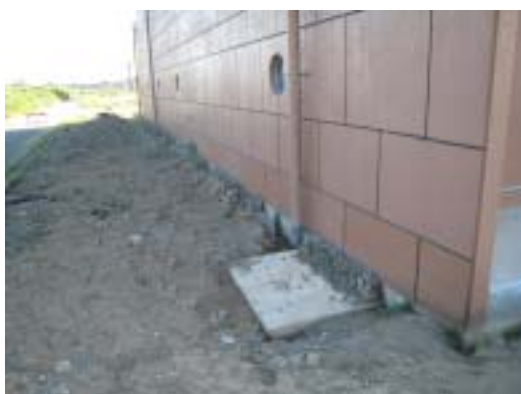
写真-1：最も海岸よりの地下室つき建物海側面（大きな沈下を既に埋め戻ししていた）
