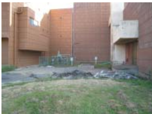
写真-3：最も海岸よりの地下室つき建物の南西側面凹部（左方向が海であり、右側側面は開きと沈下、右側側面は圧縮を示す）
