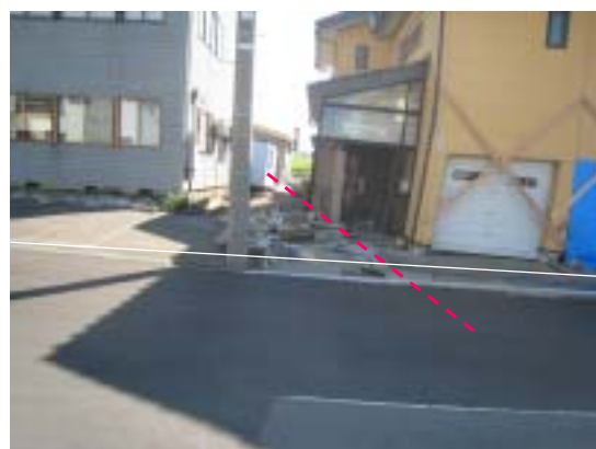
写真-8：松波2丁目の断層上にある被災家屋(記念公園の亀裂と同一線上にある)
