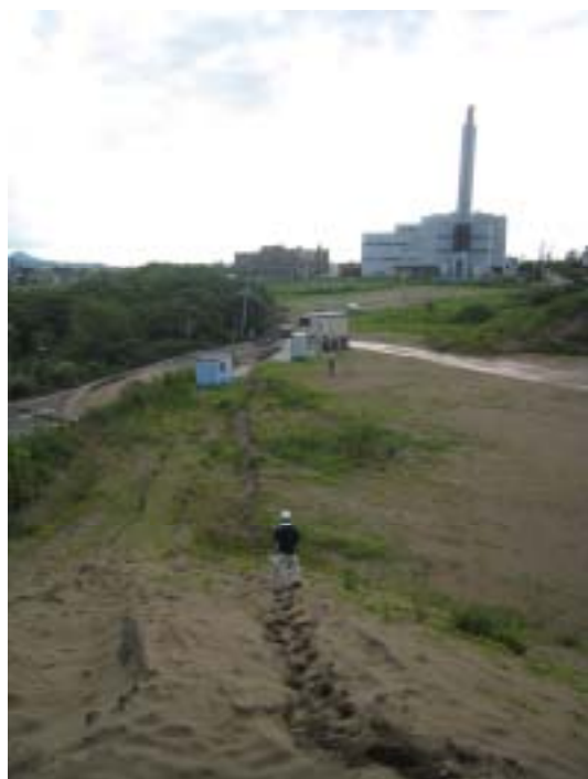
写真-9：クリーンセンター横、山本砂採取場の亀裂（側方流動にしては直線性が良すぎる。ここは砂丘性の切土地盤で大規模な流動は起きにくい。記念公園の亀裂のほぼ延長上にある。）
