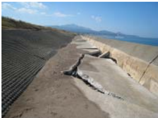
写真-14 柏崎海岸前面コンクリート護岸の前方への傾斜と背後地盤の沈下
